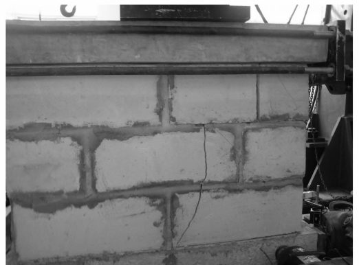
图 9 墙体 3 裂缝分布
